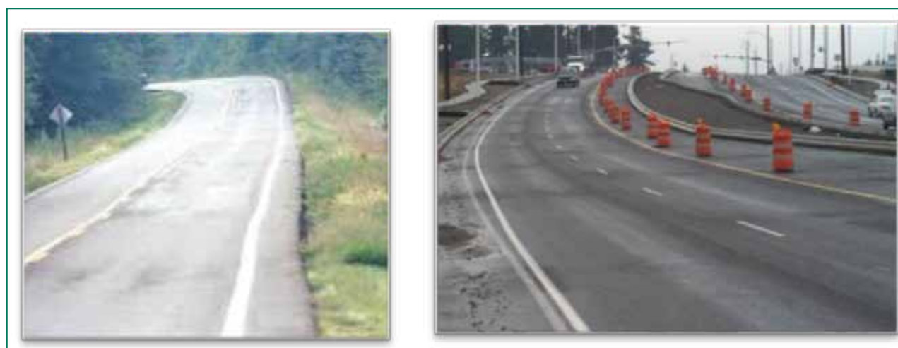
10. ábra: Példák a ciklikus hőmérsékleti szegregáció következtében bekövetkező aszfaltkeverék-romlásra (Brock, Jakob, 2019: 19. o. ; Hedderich, 2014: 5. o.).
