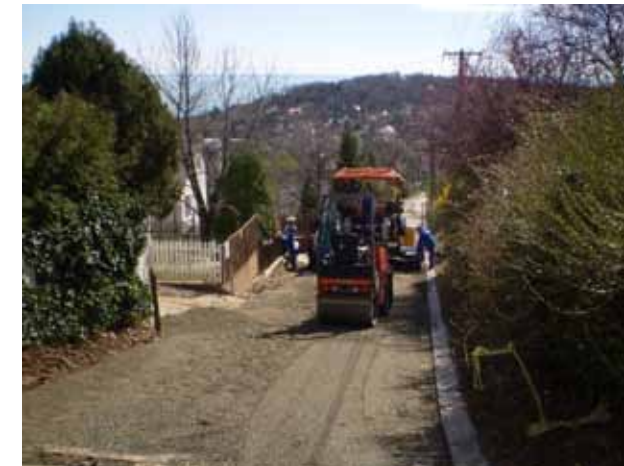
Példa a szabályozatlan minőségirányítású útfelújításra
