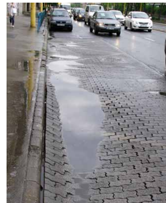
5. kép: Nyomvályúsodott, nem víztelenített, nem megfelelő rétegrenddel készült autóbussmegálló – felülről vízáteresztő, alulról vízzáró pályaszerkezet
